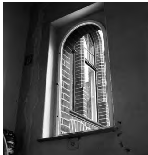
Fenster müssen ertüchtigt werden.
