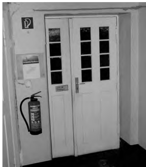
Türen müssen rauchdicht gemacht werden ...
